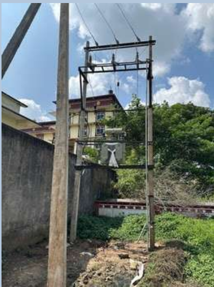
De "transformer", geplaatst net buiten de muur vanwege het gevaar voor de kindmonniken
