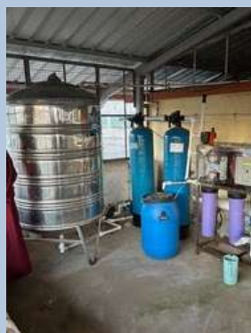
De nieuwe zuiveringsinstallatie
